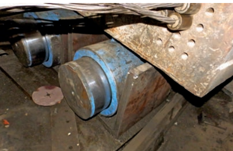
Fot. 7. Zbliżenie na dolną część belki oporowej leżącej na skrzyniach z siłownikami. Belka w momencie wypadku została wyrzucona w górę nad tłoczkami siłowników i skrzyniami
