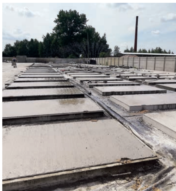
Fot. 3. Prefabrykaty betonowe w formach
