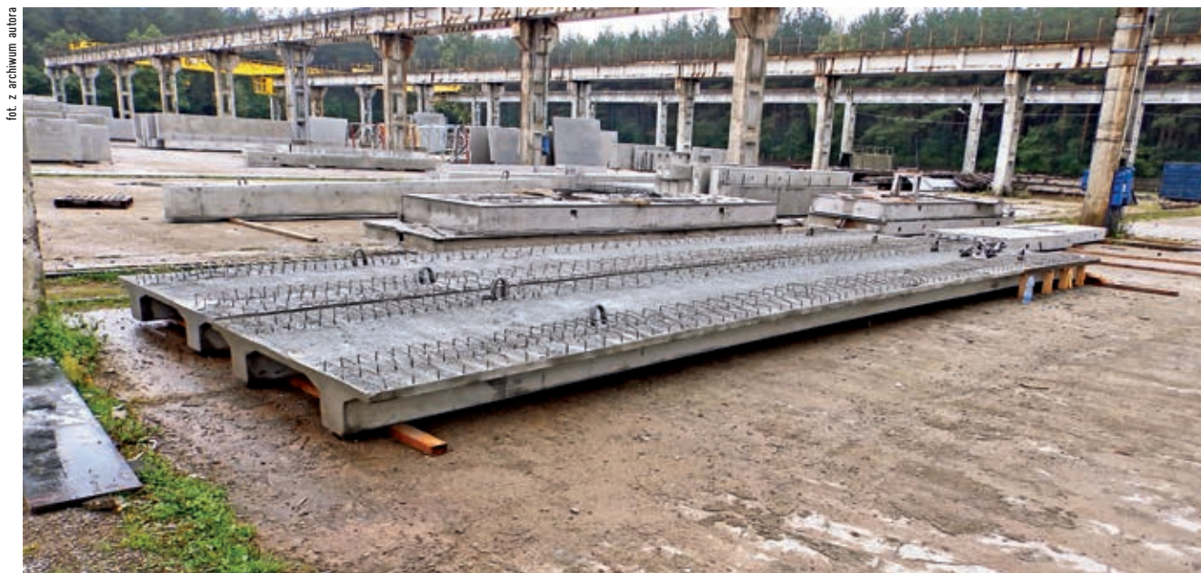
Fot. 8. Płyty TT składowane na placu. Podczas zwalniania naciągu identycznych płyt doszło do wypadku
